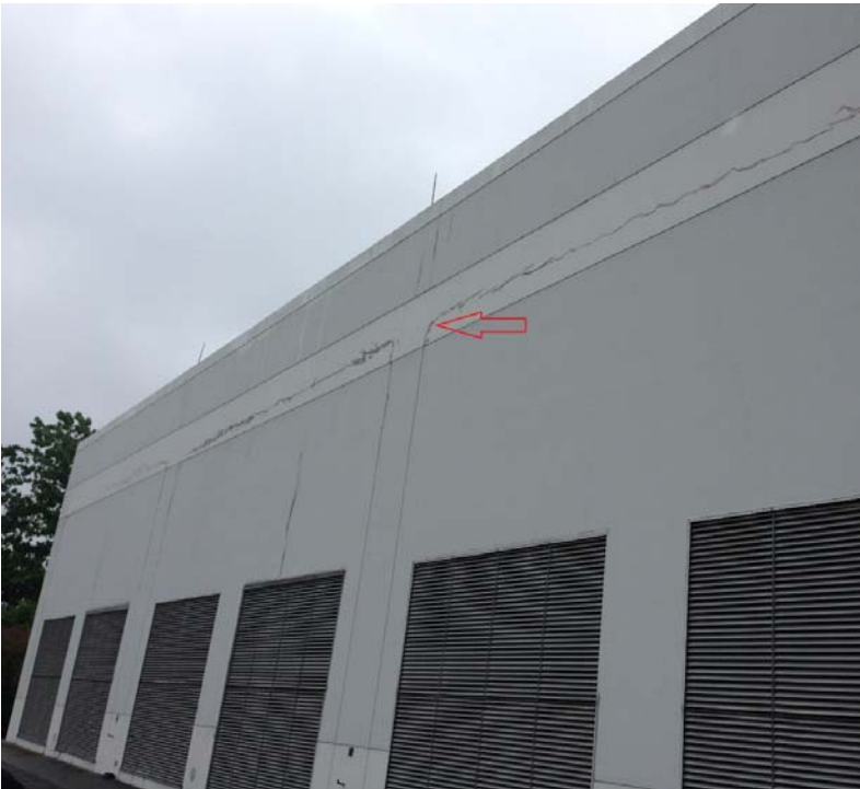
基层开裂严重，大面积结构裂缝
