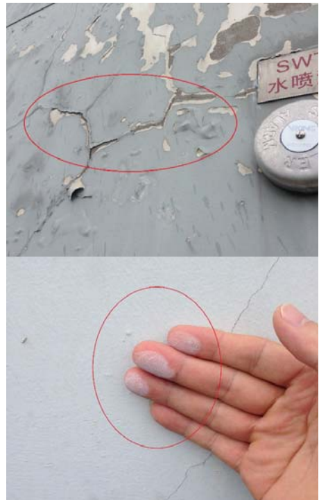
现场漆膜严重起壳/脱落，旧漆膜粉化严重
